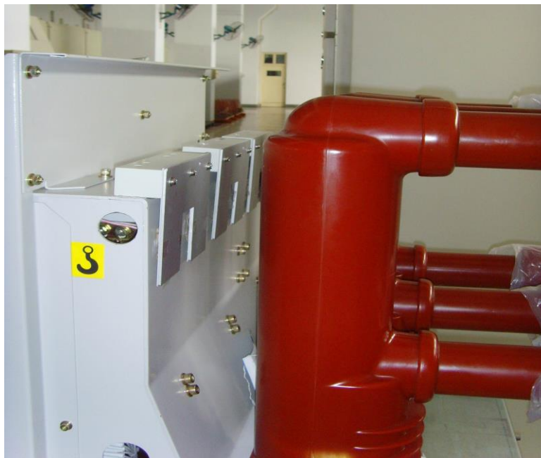
图9 天线和真空断路器组合安装示意图 (天线安装应处于断路器绝缘安全距离以外)
